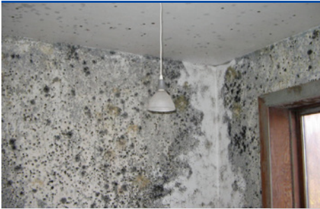
Skimmelvækst i opholdsstue efter vandskade. (Foto: Prottox/kundefoto)
