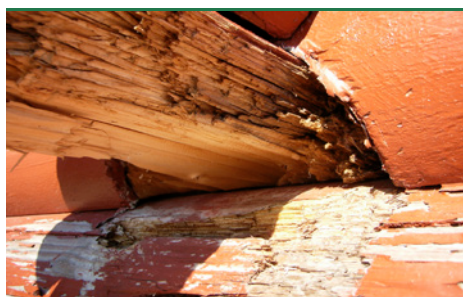
Korkhat - nedbrydning i bjælkehus. (Foto: Protox)
