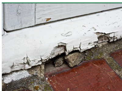
Gråmuld (Overfladeråd) - drypnæse på gammelt vindue.
