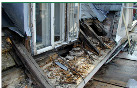
Almindelig råd - tagfod nedbrudt. (Foto: Tryg Forsikring)
