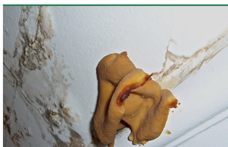
svn 18 Bæggersvamp - frugtlegeme på væg ved fødder. (Foto: Bøgh & Helstrup)
