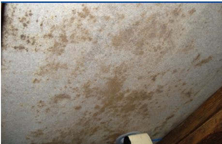
Skimmelvækst på diffusionstæt undertag (filtet overflade). (Foto: Prottox)
