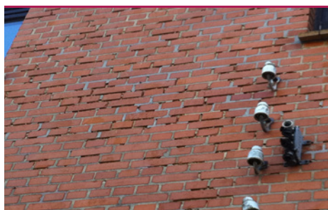
Murbier - fuger i murværk delvist nedbrudte. (Foto: Protox)
