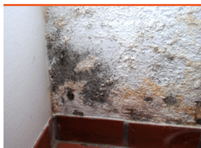
Skimmelangreb i kælderrum
