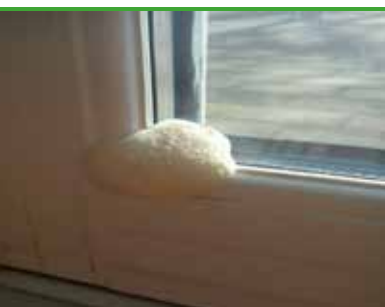
sv 39 Slemsvamp - ung fruktkropp i delaminerad fönsterkarm (foto - Protox)
