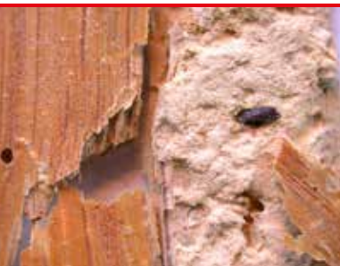
i 23 Splintbagge - nedbrutet virke med bormjöl och flyghål (foto - Hussvamp Laboratoriet)
