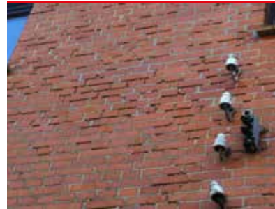
Väggsidenbi - förstörda fogar i murad gavel (foto - Prottox)
