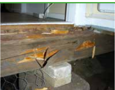
sv 9 Pulverskinn- nedbruten bjälke med intakt yta (foto - Goritas A/S)
