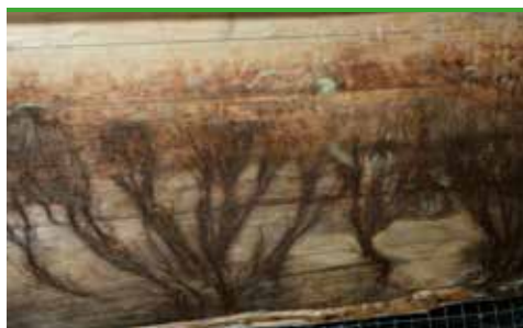
svn 32 Pulverskinn - brunt strängmycel på limträsbjälke (foto - Protox)
