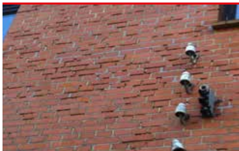
in 23 Väggsidenbin - fogar i murverk delvis nedbrutna (foto - Protox)
