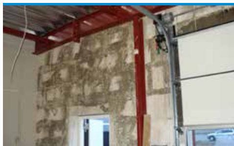
skn 12 Mögelpåväxt på nybyggd vägg i industri lokal till följd av byggfukt (foto - Protox)
