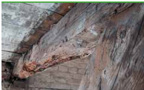
svn 56 Vanlig röta i blottad vindsbalk (foto - Protox)
