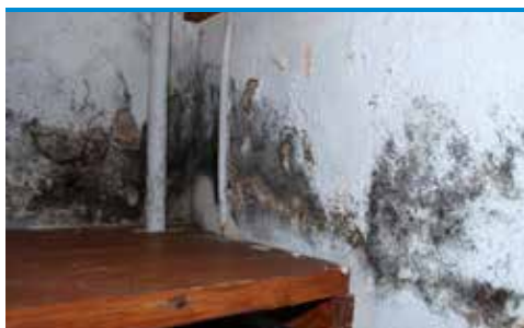
skn 6 Svartmögel på fuktbelastad källargrund (foto - Protox)
