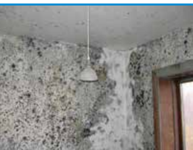
sk 3 Mögelpåväxt i ett familjehus efter omfattande vattenskada (foto - Protox/kundefoto)
