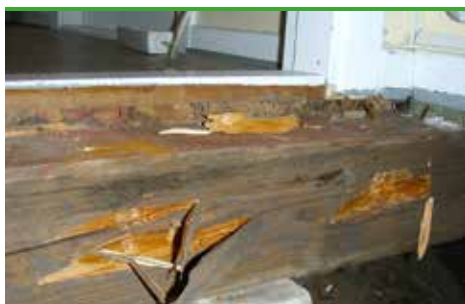
svn 41 Pulverskinn - balk med intakt yta. Angripen inifrån (foto - Goritas)
