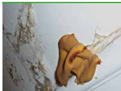
Skålsvamp - frukt-kropp på putsad vägg (foto - Bøgh & Helstrup)
