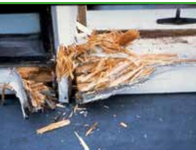
sv 29 Skinnsvamp (vitträta) i fönsterbottenkarm (foto - Goritas A/S)
