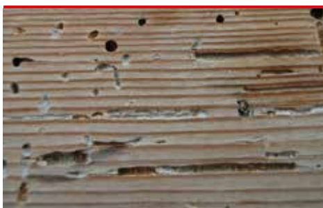
in 16 Strimmig trägnagare i golvbräda - flyghål och larvgångar blottade på grund av hyvling (foto - Protox)
