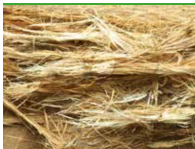
Vitröta - svampen nedbryter ligninet i träet och kvarlämnar cellulosastrådarna. Därmed trådar virket.
