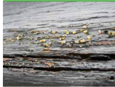
Vedplätt på trävirke utomhus (foto - Goritas A/S)
