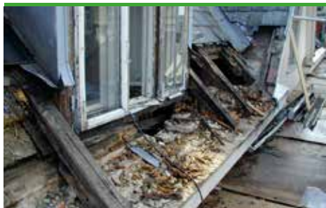
svn 55 Vanlig röta- takfot nedbruten (foto - Tryg Forsikring)
