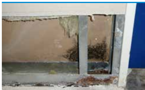
skn 10 Mögelpåväxt ( Stachybotris chartarum ) i lätt gjipsvägg efter översvämning (foto - Protox)
