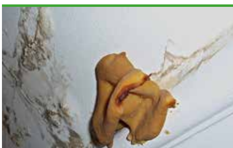
svn 18 Skålsvamp - fruktkropp på vägg vid golvlister (foto - Bøgh & Helstrup)
