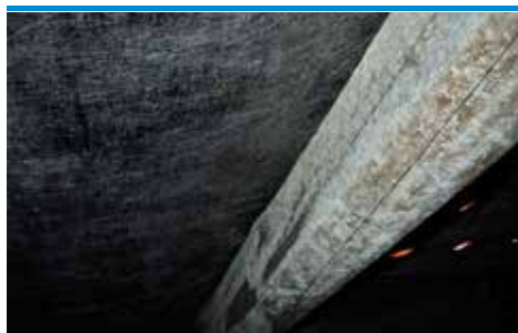
skn 3 Mögelpåväxt (Penicillium sp.) på bjälke till följd av otillräcklig ventilation (foto - Protox)
