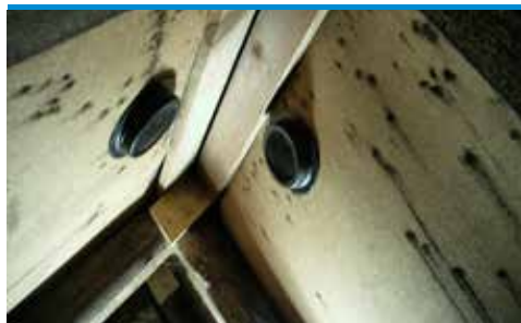
skn 8 Svartmögel på undertak p.g.a. bristfällig ventilation av vind (ventiler eftermonterade) (foto - Protox)
