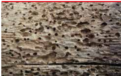
in 19 Skäckig trägnagare - flyghål i gammal bjälke (foto - Protox)
