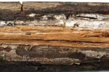
sv 28 Skinnsvamp (vitträta) i fönsterram (foto - Protox)
