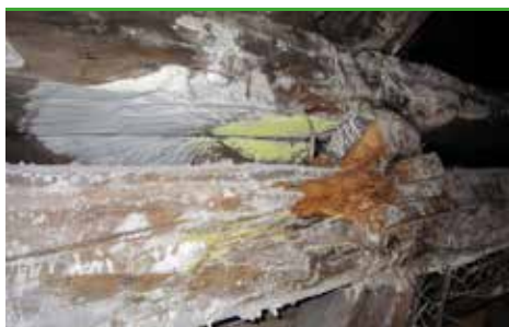
svn 33 Mögelticka - angrepp i takkonstruktion. Kalkliknande fruktkroppar, ungt, vitt ytmycel och böjbara strängar (foto - Bøgh & Helstrup)
